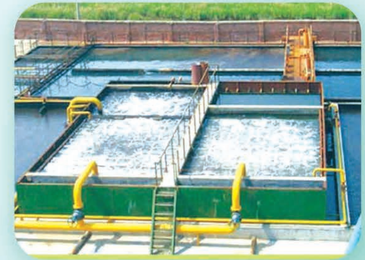
EFFLUENT TREATMENT PLANTS (ETP)
